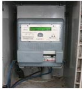
CONTATORE DI ENERGIA (origine dell'impianto)
