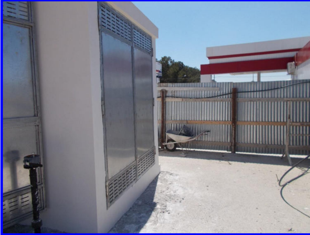
Lato destro del corpo di fabbrica con relativa porta di accesso al piccolo vano per l'installazione del gruppo di misura e tubazione di aspirazione gas proveniente dal metanodotto
