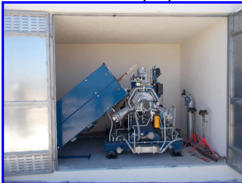
Vista frontale vano principale
