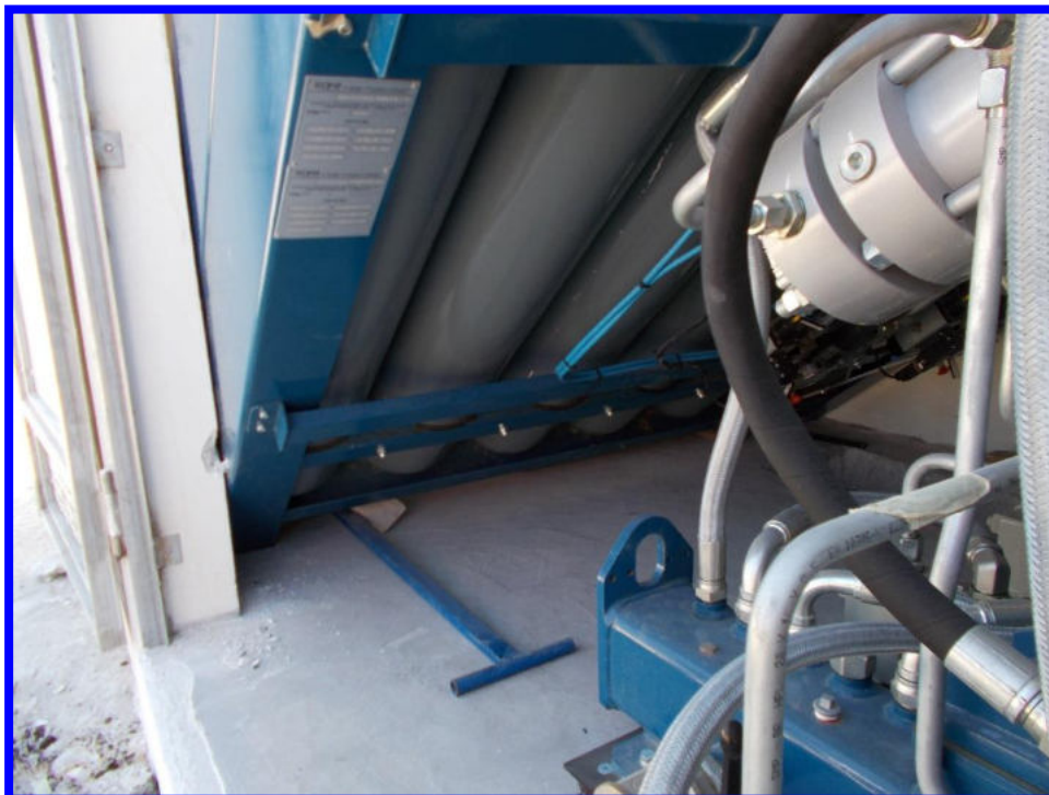
Vista dell'asta di manovra del carrellino a rulli
