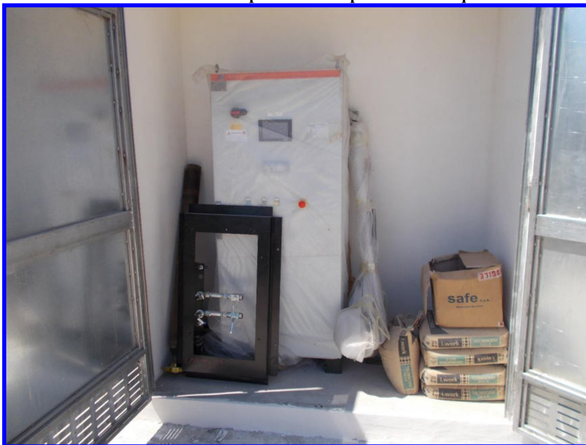
Piccolo vano lato sinistro del corpo di fabbrica per allocazione quadro elettrico
