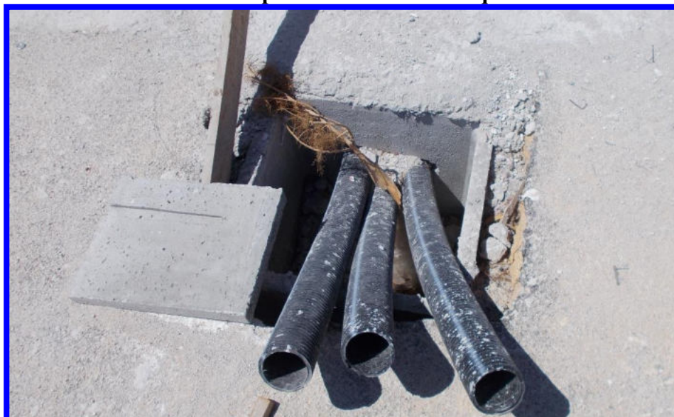
Pozzetto lato sinistro per alimentazione del quadro elettrico
