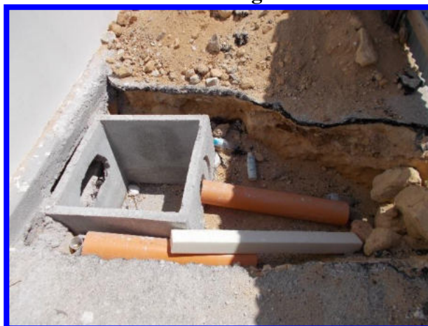
Pozzetto retrostante il corpo di fabbrica per il passaggio delle tubazioni di adduzione alle colonnine erogatrici.
