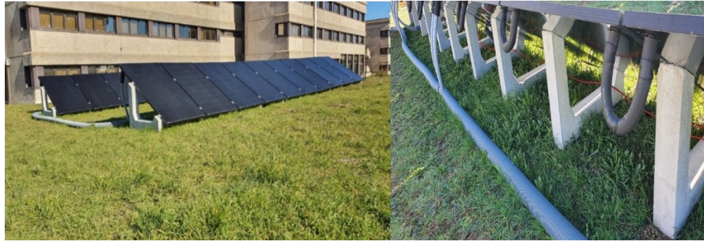
PVT : 8,1 kWp - 22,3 kWt
