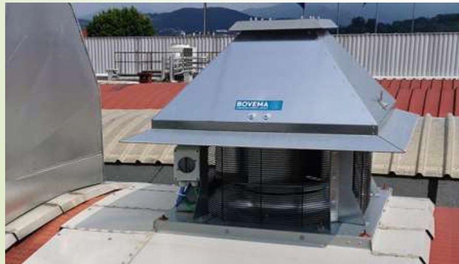
SEFFC Sistema Evacuazione forzata fumo e del calore (SEFFC)
