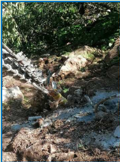
Ancoraggi dei controventi laterali danneggiati
