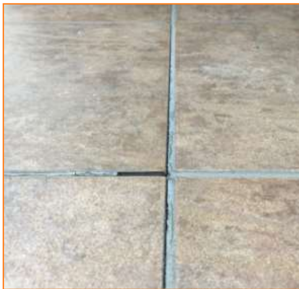
Rottura della fuga
