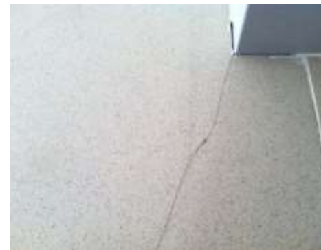
Danni causati dal supporto
