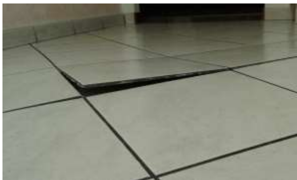
Danni da dilatazioni non compensate
